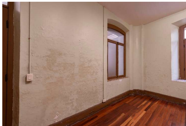
Foto 8,9,10,11, Paredes, Cielos, Ventanería, Sótano. Causa: Humedad por Filtración y por Capilaridad, Fuente: Ing. Wagner Calderón Rizo, Fecha Junio del 2020
