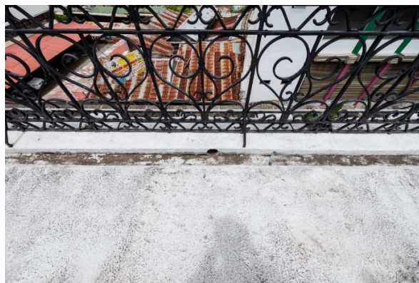
Foto 9. Boquilla de bajante sin rejilla que impida el ingreso de objetos extraños a los bajantes.
