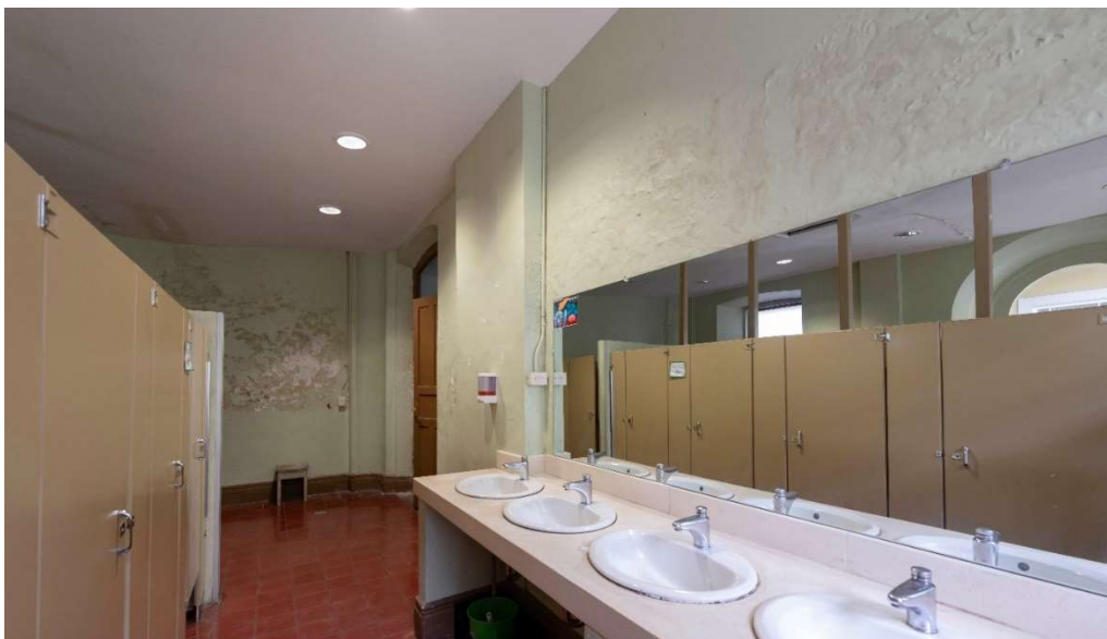
Foto 18. Servicios sanitarios dañados por humedad.
