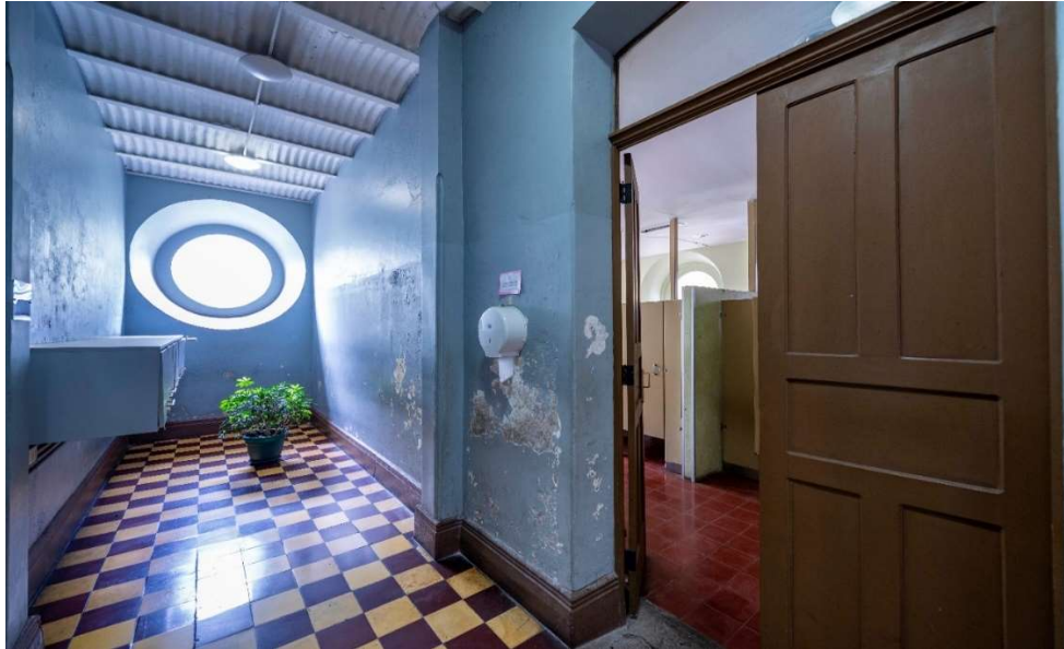
Foto 17. Humedad en las paredes exteriores de servicios sanitarios del sótano.
