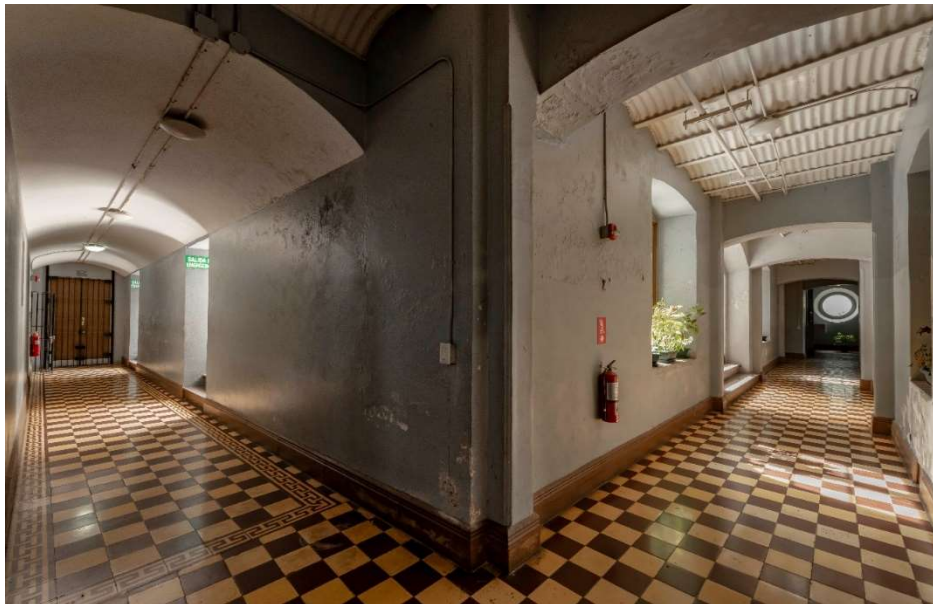
Foto 22. Pasillos sur y este del sótano con fuertes daños por humedad en pintura y repellos.
