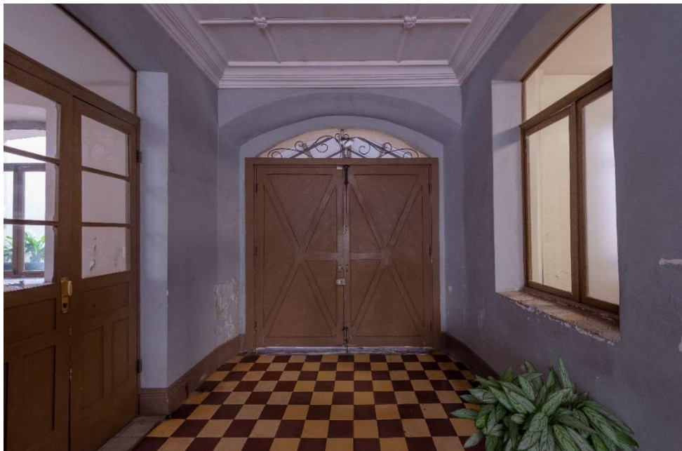
Foto 23. Pasillo entre sala de profesores y servicios sanitarios con repellos y pinturas afectados por la humedad.
