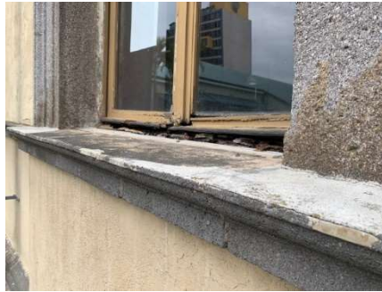
Foto 51, Deterioro del marco debido al ingreso de humedad por la banquina, Fuente: Ing. Co. Andrea Aguilar, Fecha junio 2020
