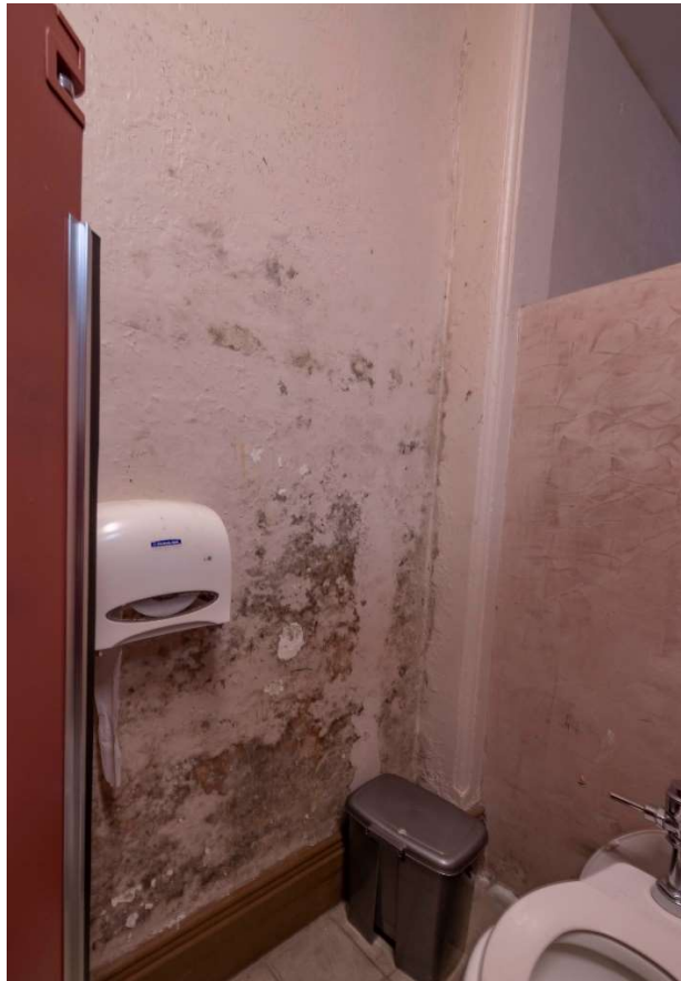
Foto 15. Daños en pintura, revestimientos y repellos en baños.
