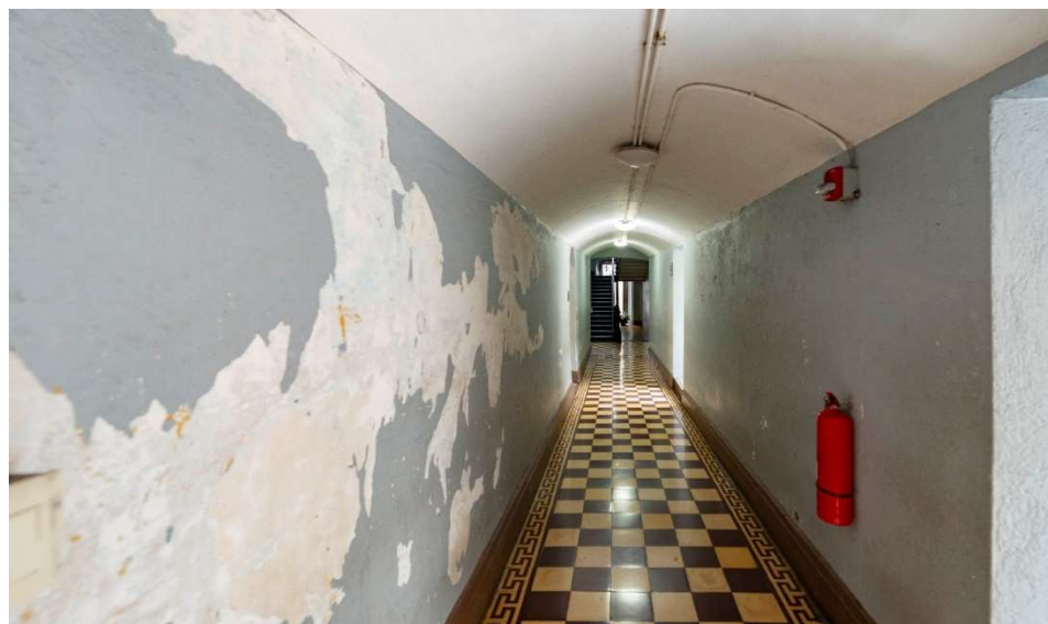
Foto 2. Desprendimiento de varias capas de pintura en el pasillo norte del sótano.
