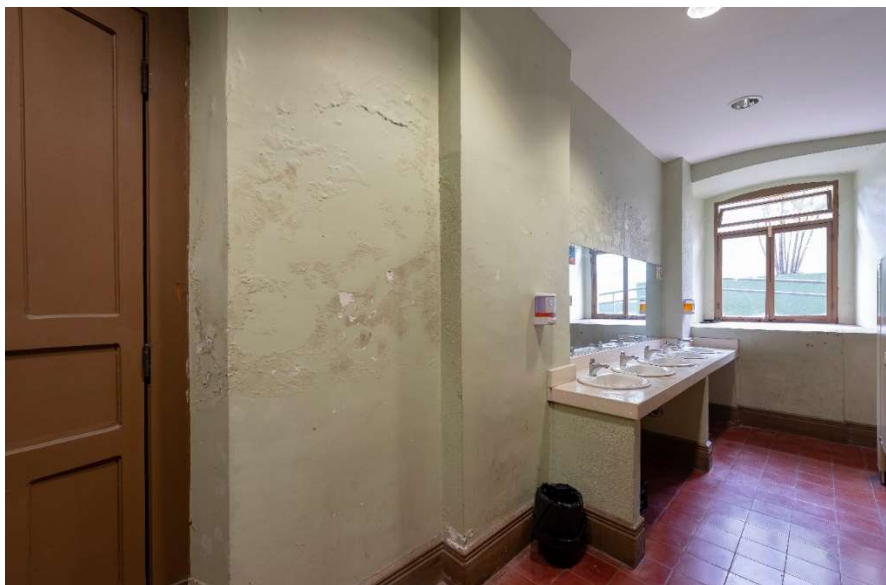
Foto 16. Daños por humedad en servicios sanitarios del sótano.
