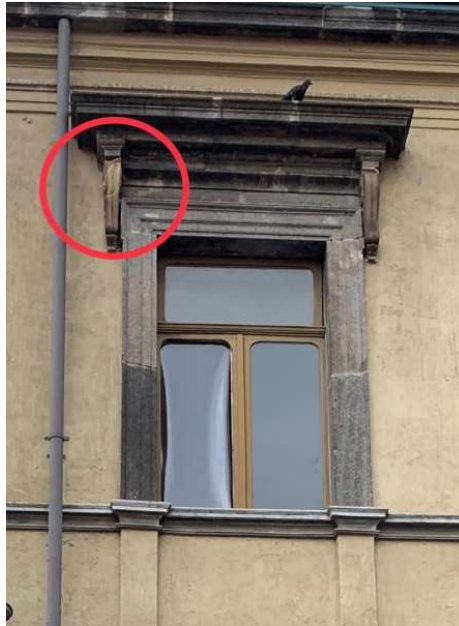
Foto # 50, Piedra fisurada, Fuente: Ing. Co. Andrea Aguilar, Fecha junio 2020
