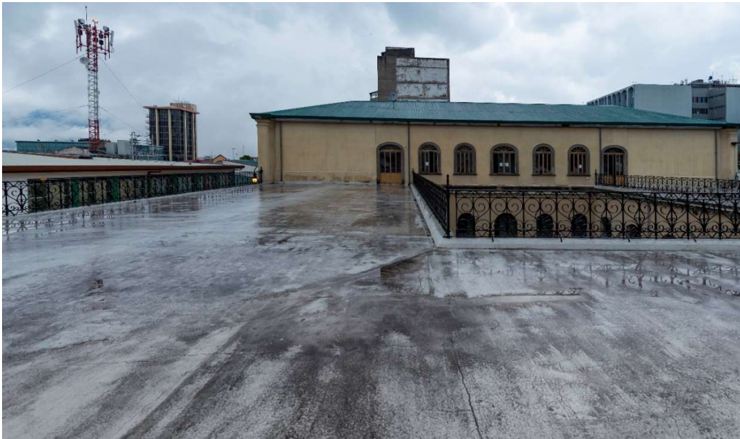
Foto 6. Losa saturada después de las lluvias.
