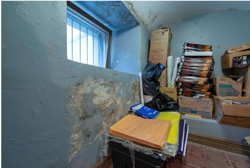
Foto 19. Bodega de material didáctico afectada por la humedad.
