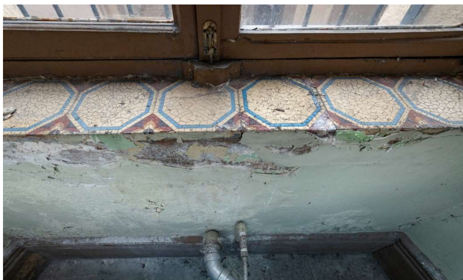
Foto 14. Daños por humedad bajo las ventanas del laboratorio de biología.
