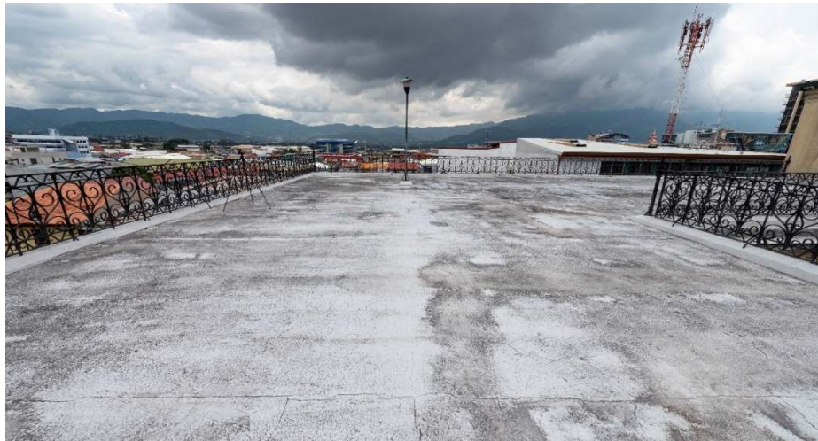
Foto 8. Vista del agrietamiento de la superficie de la losa.
