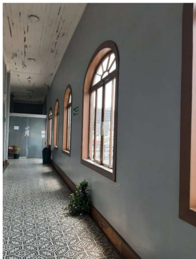
Foto 79, Estado conjunto de Ventanería Fachada Este, Fuente: Mario Caves, Fecha: junio 2020
