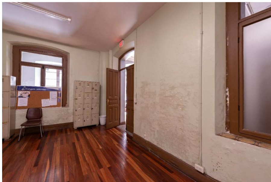
Foto 20. Sala de profesores con alto daño por humedad.
