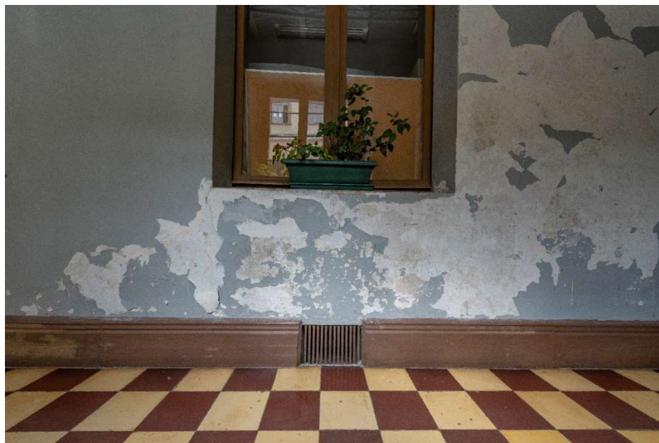
Foto 1. Humedad en la pared externa de la sala de profesores en el sótano.
