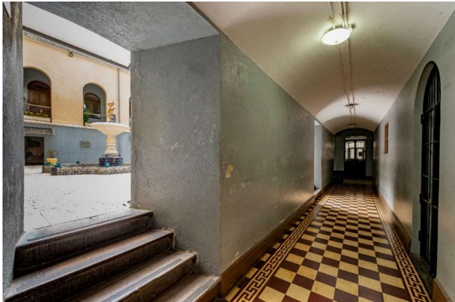
Foto 21. Pasillo sur del sótano dañado por la humedad.
