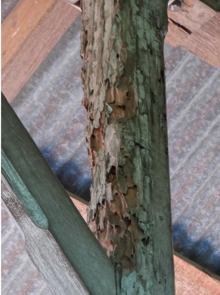
8. COLUMA INTERNA DETERIORADA
