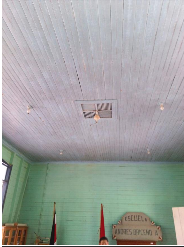
Figura 3 Deflexiones en cielo y mal estado de tablilla
