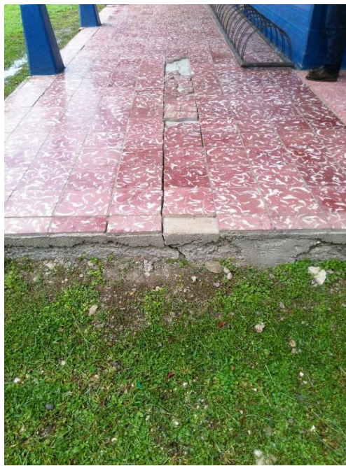
Figura 10 Falla en terraza, afecta el tránsito
