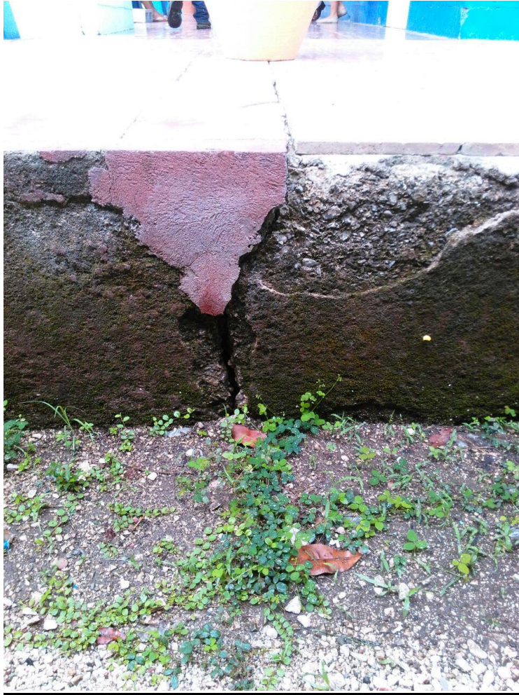
Figura 4 Grieta de falla en relleno de terraza
