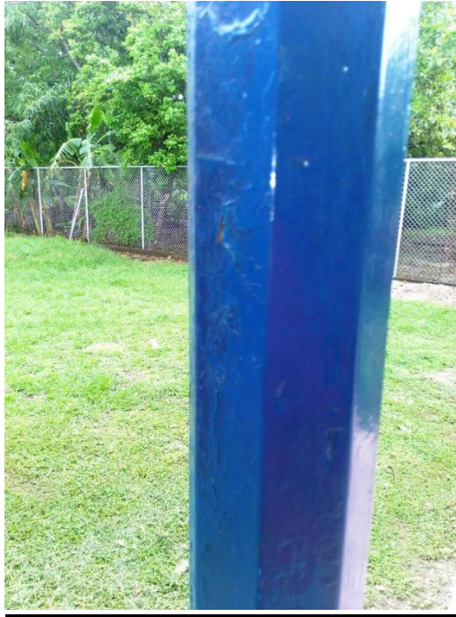
Figura 7 Golpes y marcas de daños en columnas
