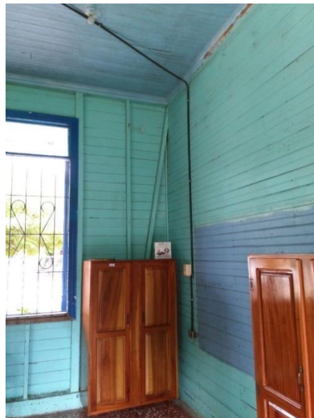
Figura 8 Problemas en pintura de paredes
