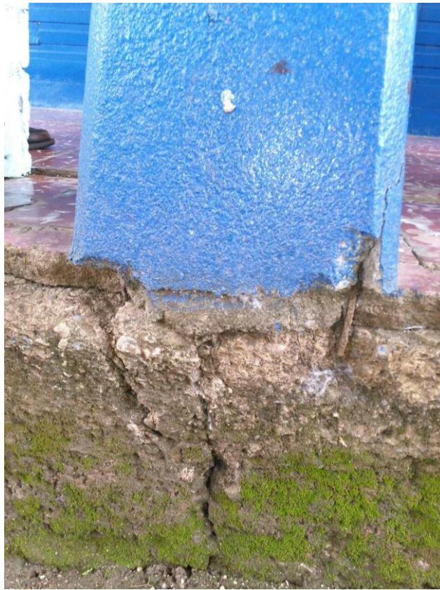
Figura 19 Cimentación de columna falló
