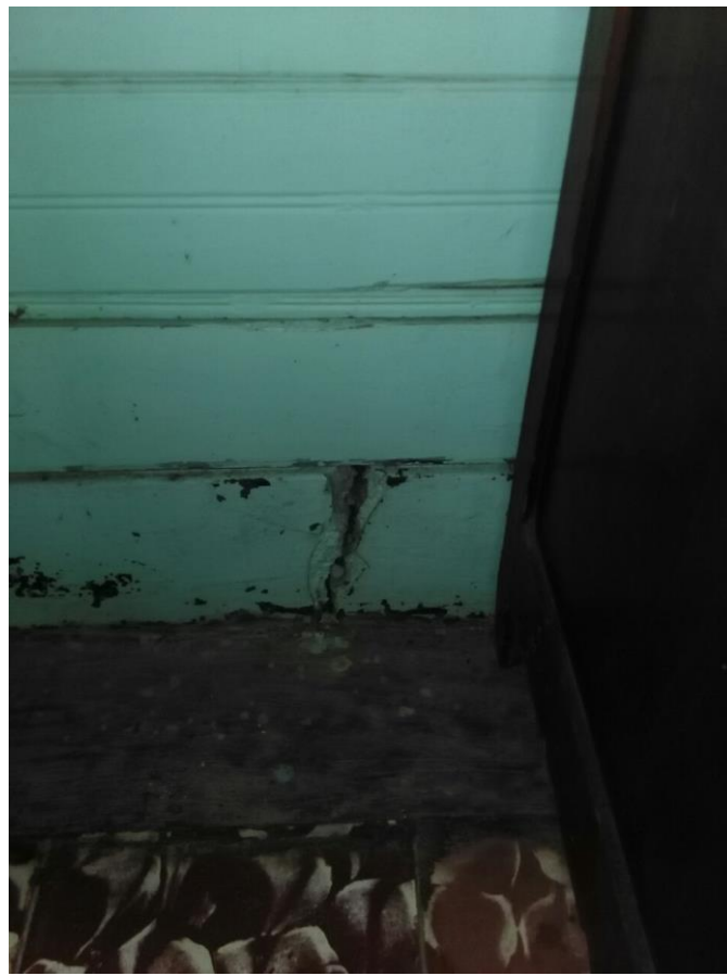
Figura 17 Cimentaciones de edificio dañadas
