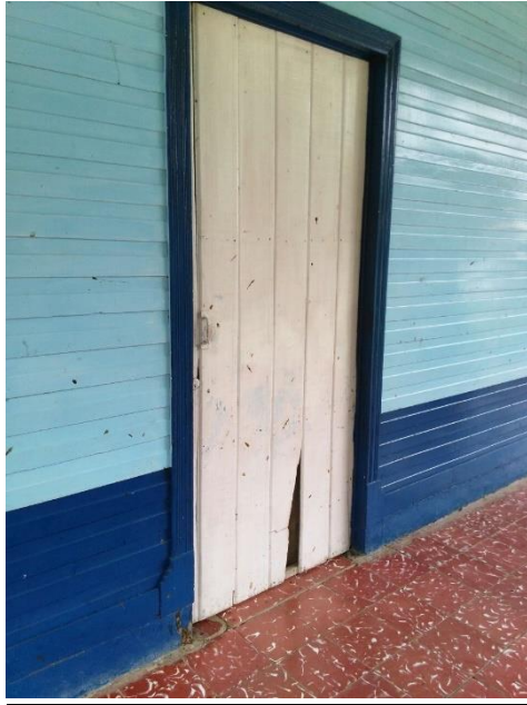
Figura 16 Puerta en mal estado
