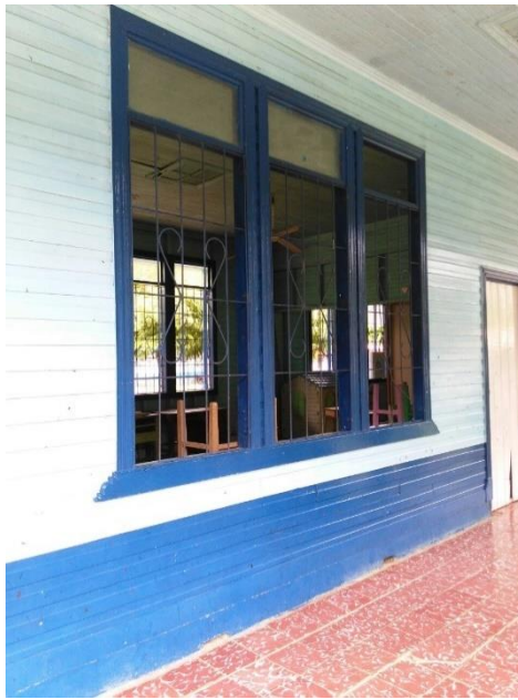
Figura 15 Ventanas sin vidrio ni barrera para mosquitos
