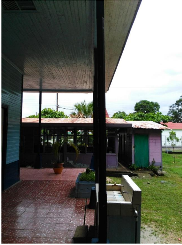
Figura 9 Columnas con excetricidad, colapso inminente
