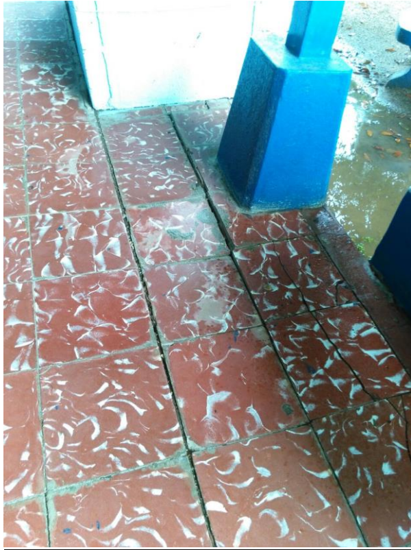
Figura 5 Vulnerabilidad de columnas de soporte de estructura
