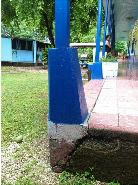
Figura 14 Colapso inminente de estructura
