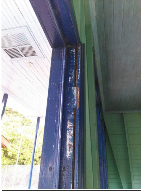
Figura 20 Bisagras en mal estado
