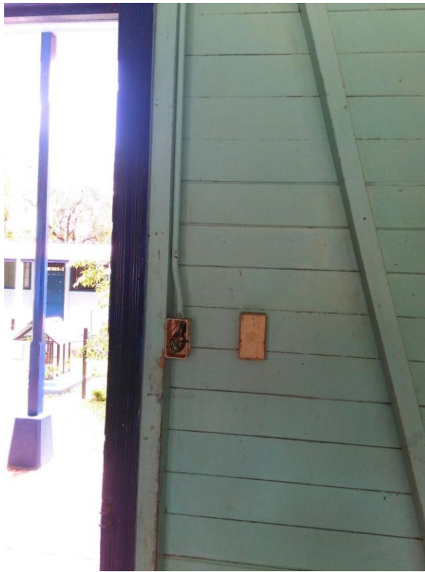
Figura 6 Caja eléctrica sin tapa (Peligro para niños)
